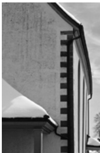
Abb. 10: Typisches Verformungsbild einer Kirchenwand: nachgiebige Wand, steife Ecken (Grub AR 2002).
