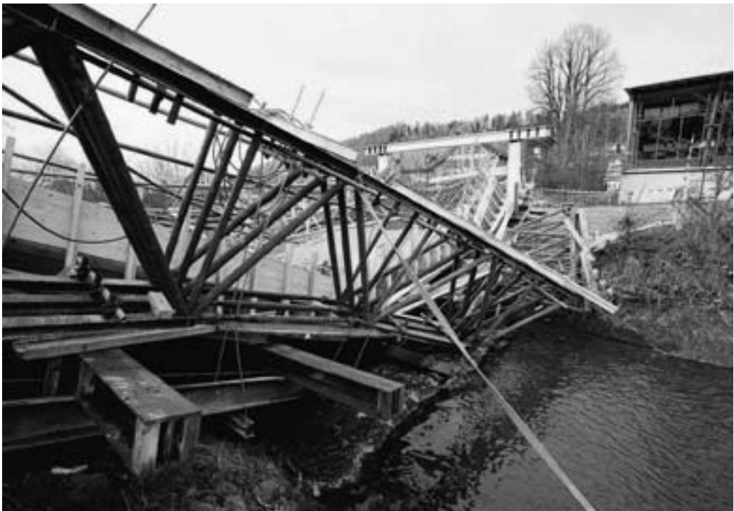
Halbwegs glimpflich verlief Anfang Dezember der Einsturz einer Brücke über den Rotbach. Sechs Bauarbeiter, die sich zur Zeit des Einsturzes auf der Brücke befanden, blieben unverletzt.
